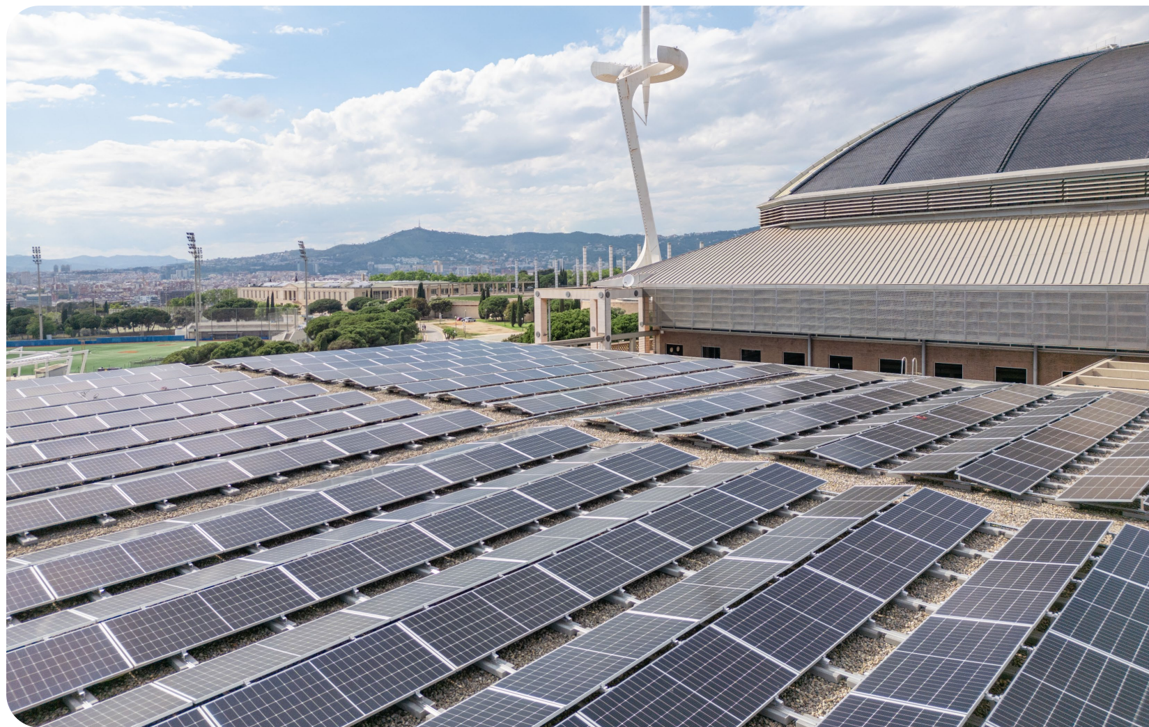
Plaques fotovoltaïques instal·lades al Palau Sant Jordi a l'Anella Olímpica, imatge d'arxiu.
